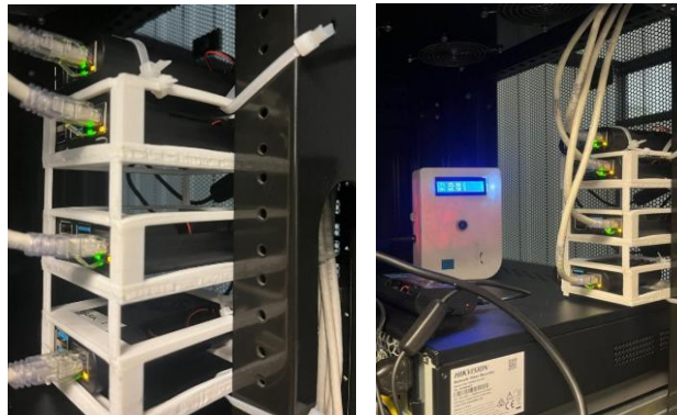
Figura 12. Representa instalación de servidores Raspberry y centro de control de temperatura.
